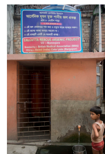
Ein Junge holt sauberes Wasser aus der Filtrationsanlage. Foto: Marion Schade
